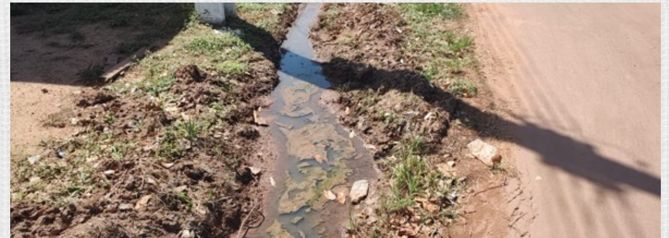
Esgoto a céu aberto, reflexo da ausência de saneamento básico em Santana
